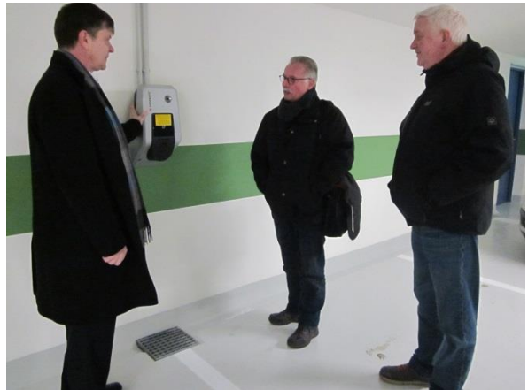
Tiefgarage mit E-Ladeanschluss
